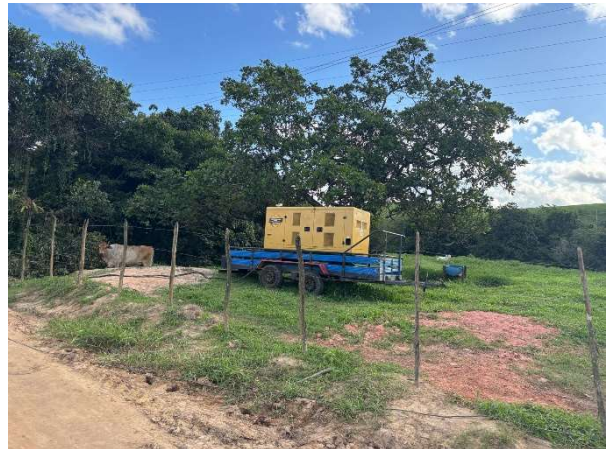
FOTO 6: Gerador para solda e martelete;
